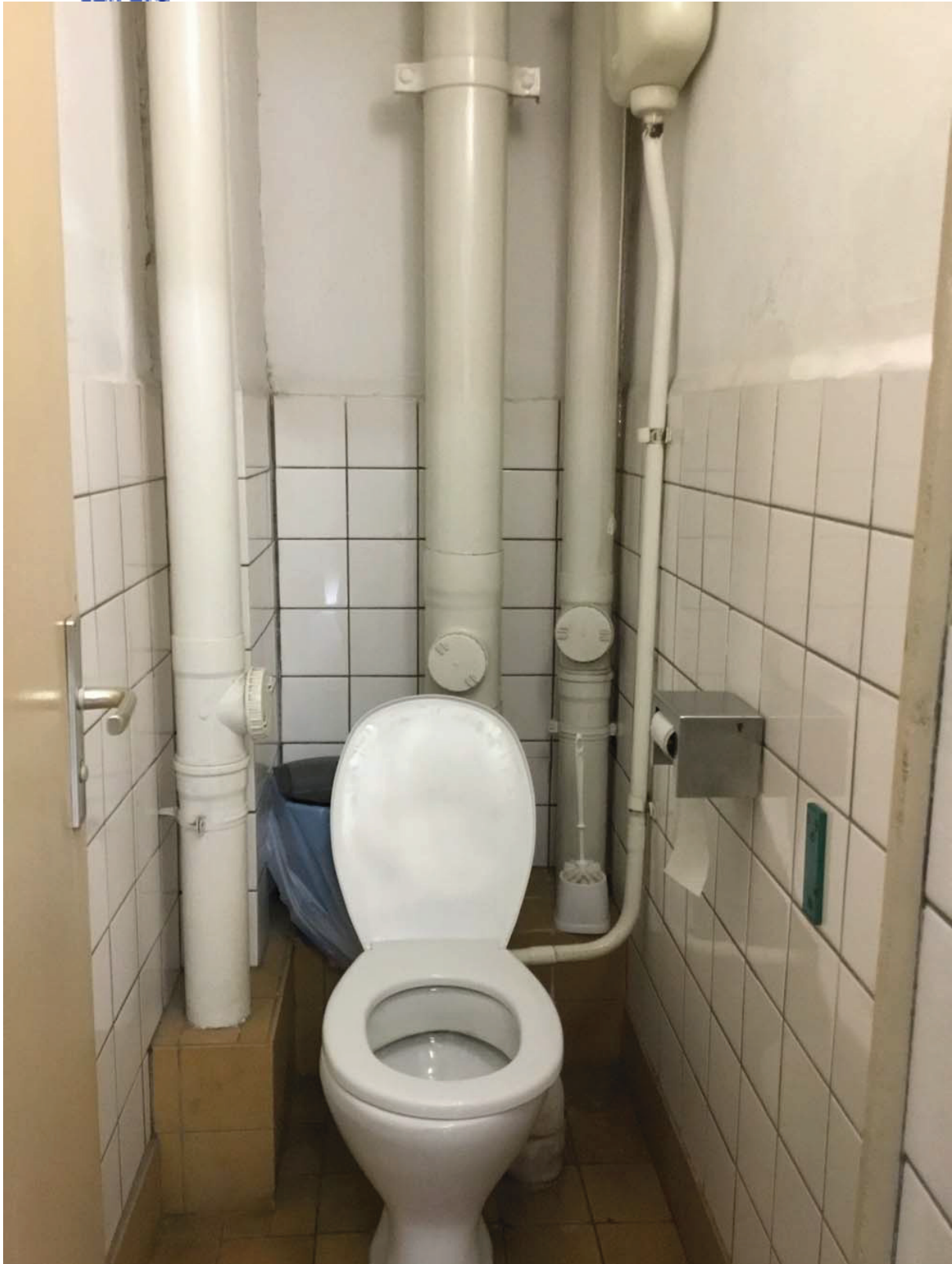
Symbolfoto aus der Turnhalle August-Bebel-Grundschule – der Zustand ist aber vergleichbar mit dem im Schulgebäude
